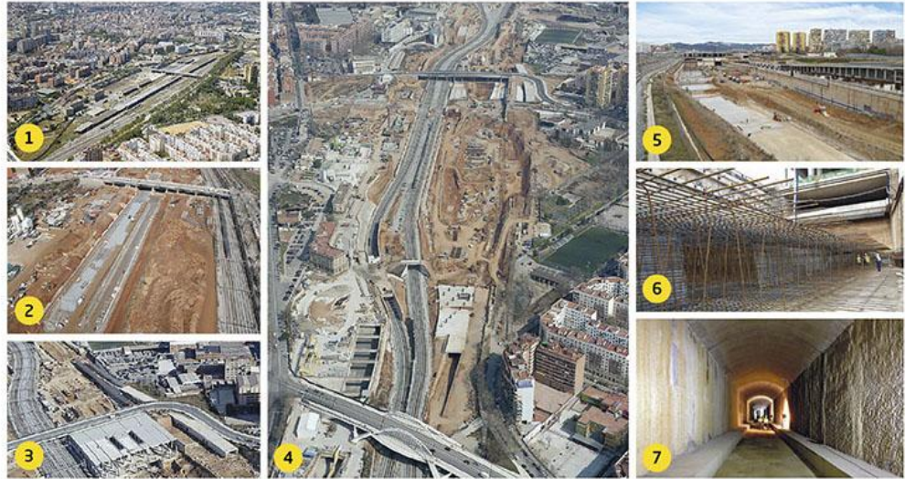
1. Antigua terminal de mercancías de La Sagrera (2007). 2. Construcción del trazado provisional (2008). 3. Inicio de la construcción de la zona logística (2013). 4. Inicio de la excavación entre pantallas (2012). 5. Inicio de la construcción de la losa de fondo (2018). 6. Detalle del armado de la losa de fondo (2018). 7. Tramo de colector de la rambla Prim finalizado (2018).
